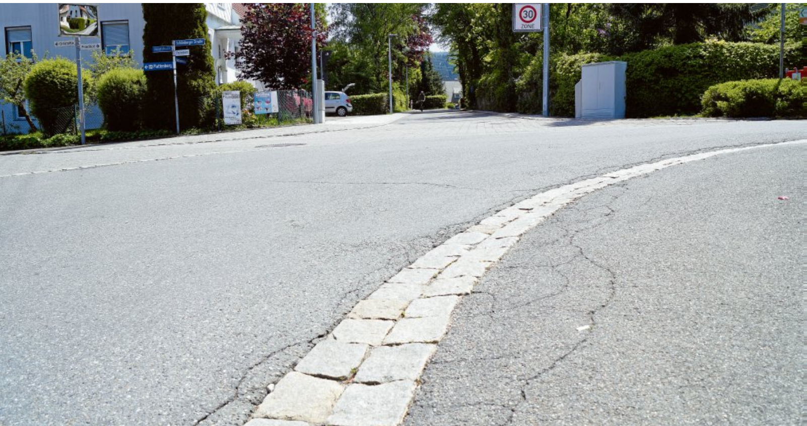
Die Schäden am Übergang vom Gehweg zur Straße sind offensichtlich.
